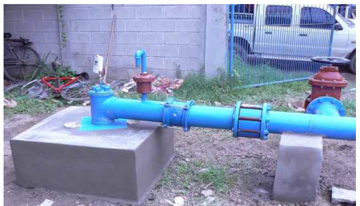
Una de las tres estaciones de bombeo para suplir el servicio de agua en Choloma. 112,550 personas beneficiadas.
